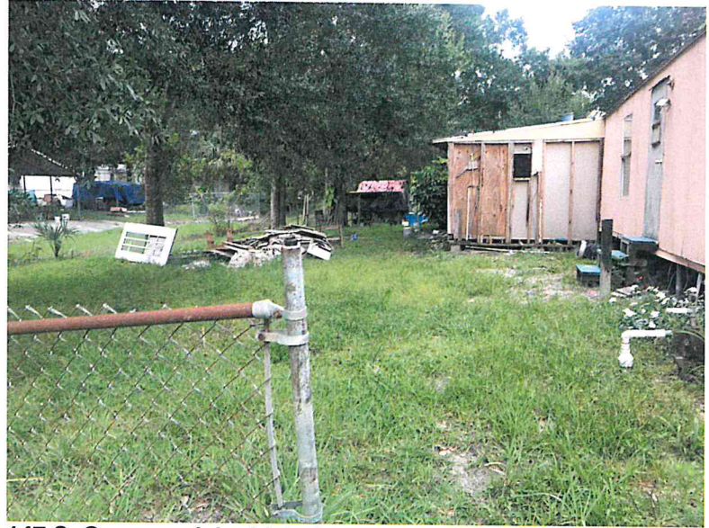
147 S. Orange - delapidated
