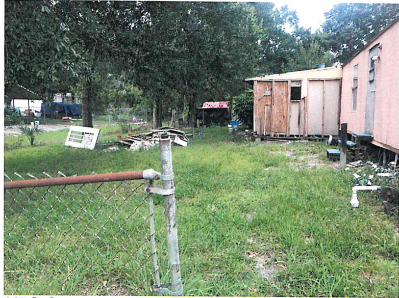
147 S. Orange - delapidated
