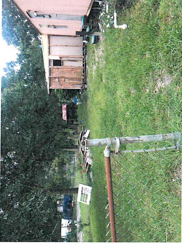
147 S. Orange - delapidated
